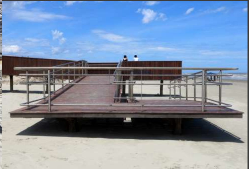
guarda-corpo em aço inox
